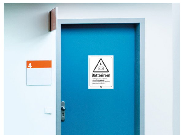
Eksempel på merking av batterierom.
